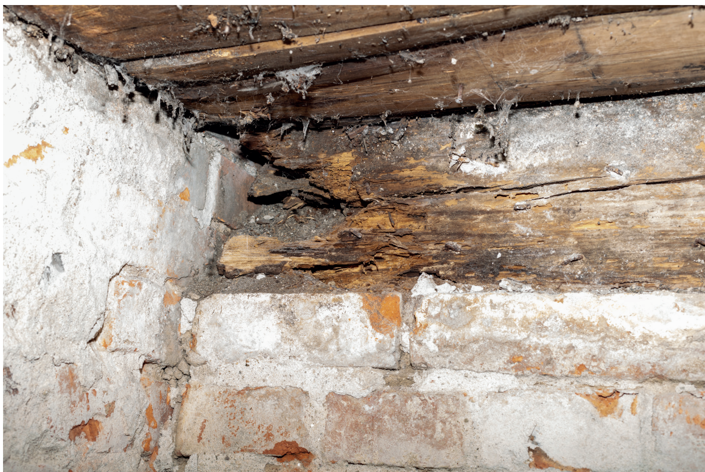
Stan zachowania belek stropu. Widoczne elementy przeznaczone do wymiany.
