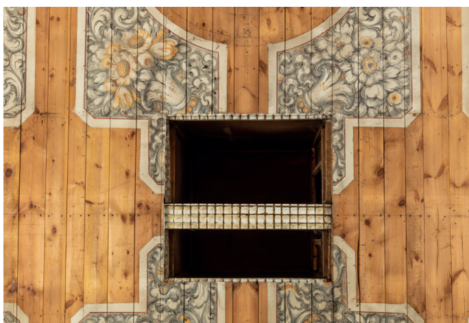
Dekorowany strop w dawnym kościele ewangelickim w Nowym Mieście Lubawskim, fragment obrazujący zniszczenia wynikające z adaptacji budynku na kino i wprowadzeniu instalacji wentylacyjnej.
