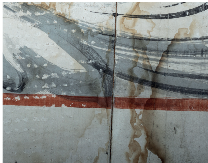
Fragment dekoracji stropu z widocznymi zaciekami i zniszczeniami spowodowanymi montażem podbitki..
