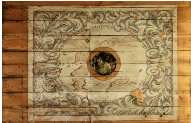
Jedna z malowanych płycin w nawie bocznej nad emporą z widocznymi zaciekami.
