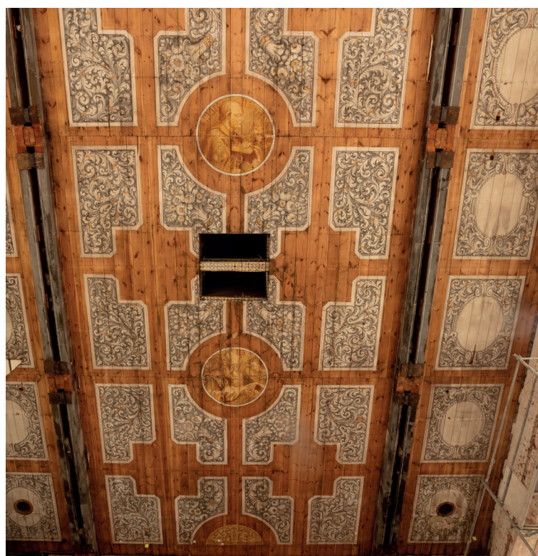
Regularna kompozycja dekoracji malarskiej na stropie nad nawą zaburzona przez wtórnie wycięte otwory na instalację wentylacyjną.
