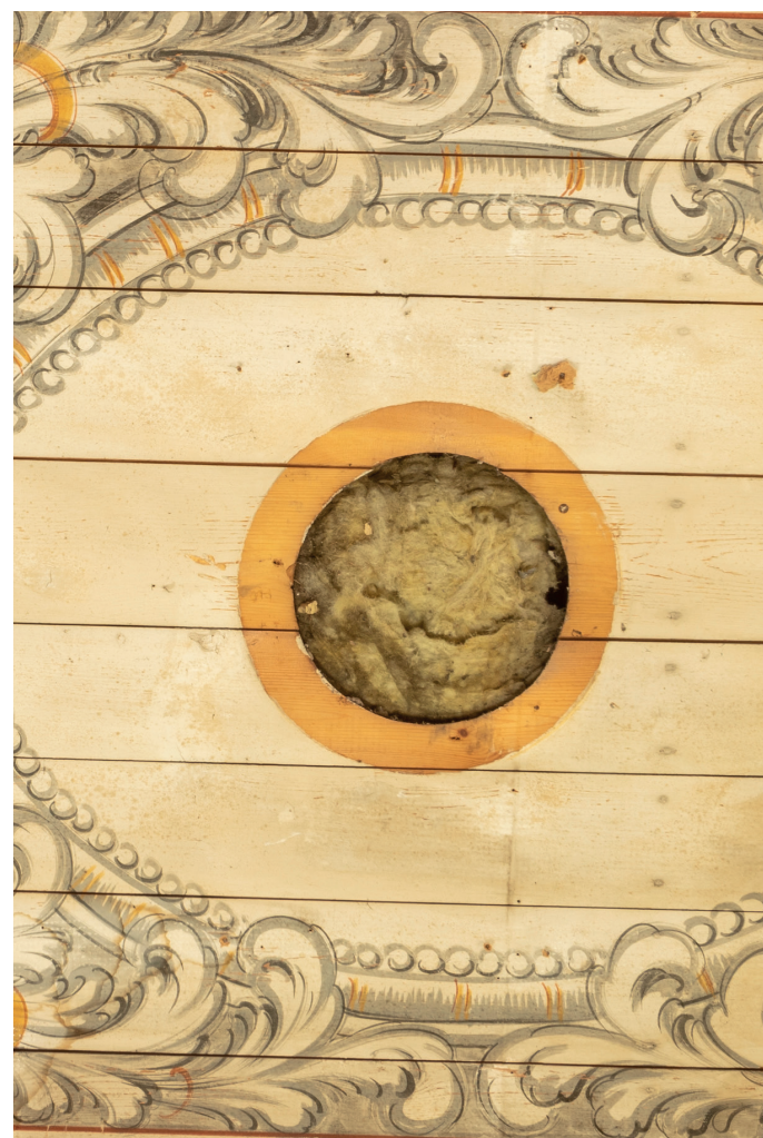
Dekorowany strop w dawnym kościele ewangelickim w Nowym Mieście Lubawskim, widoczne docieplenie stropu wełną mineralną i wypełnienie wszystkich otworów wentylacji grawitacyjnej.
