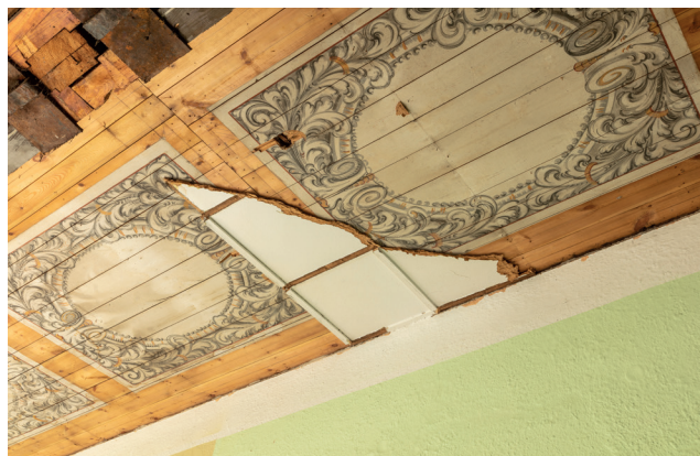
Fragment stropu kościoła z widocznymi resztkami współczesnej podbitki z płyty paździerzowej.
