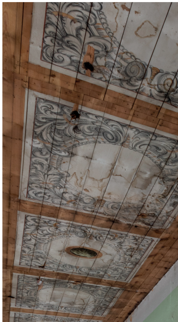
Polichromowany strop nad emporą. Stan zachowania wskazuje na częste zaciekanie wody opadowej z dachu na deski stropowe.
